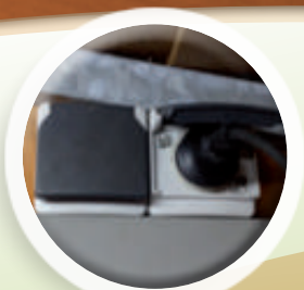
2 prises de 220 V à chaque extrémité. 2 220V sockets at each end.
