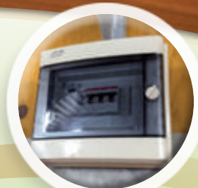
Coffret électrique avec protection 30 mA. Electrical box with 30 mA protection.
